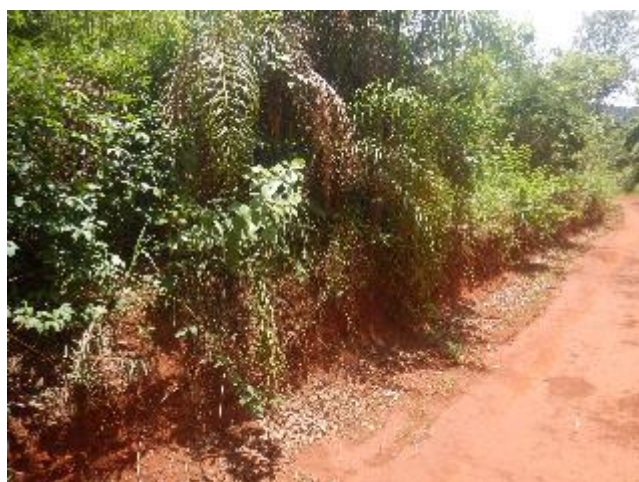
Foto 411 - Vista geral da área cortada pelo empreendimento com solo residual de coloração marrom avermelhado.
