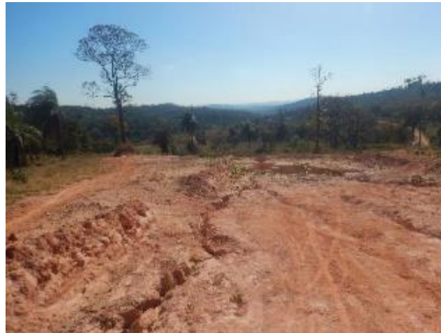
Foto 290 – Vista geral da área cortada pelo empreendimento com exposição de solo siltoso de coloração marrom -avermelhada e processos erosivos.
