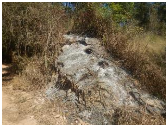
Foto 307 - Vista geral da área cortada pelo empreendimento com exposição de solo siltoso de coloração creme.
