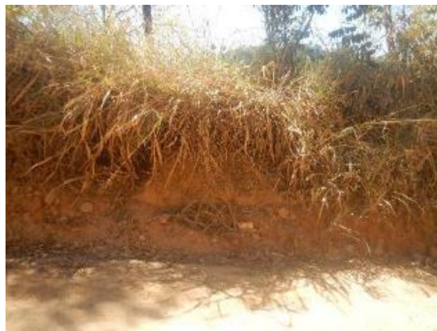
Foto 310 – Detalhe do corte com exposição de solo siltoso de coloração creme - avermelhado.
