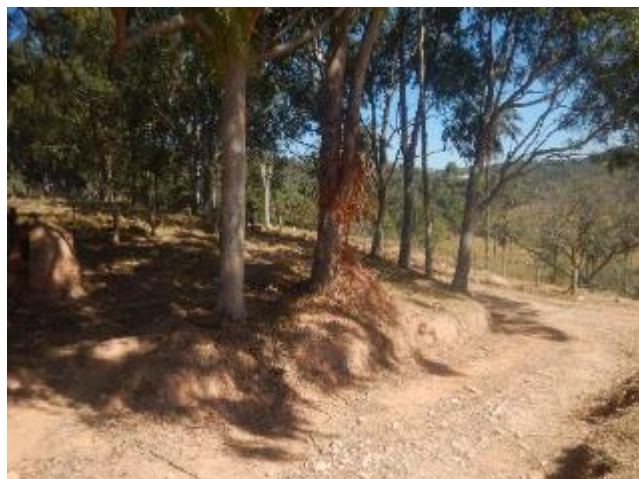
Foto 297– Vista geral da área cortada pelo empreendimento com exposição de solo siltoso de coloração marrom -avermelhada e pastagem.
