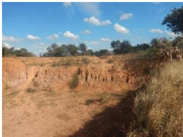
Foto 257 – Vista geral da área cortada pelo empreendimento com exposição de solo siltoso de coloração marrom -avermelhada e processos erosivos.
