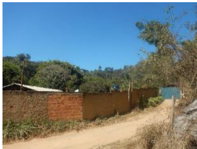
Foto 306 – Vista geral da área cortada pelo empreendimento com exposição de solo siltoso de coloração creme.
