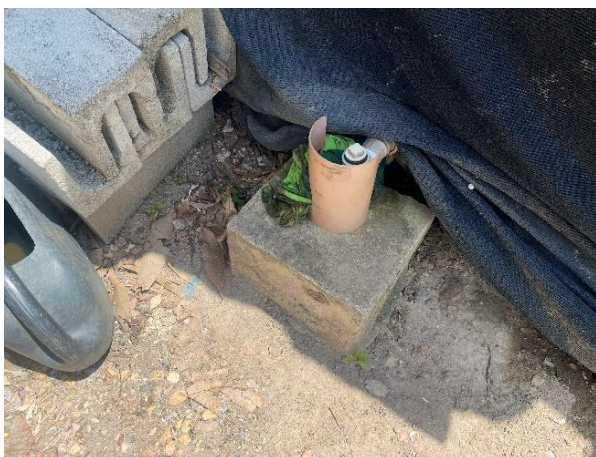
Figura 12.2-21 – Captação subterrânea utilizada para irrigação – Ribeirão das Neves.
